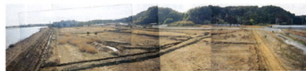
着工直後の様子。湿地改良の排水トレッチが配線に囲まれた（02年1月）*
